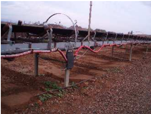
Pohled na dopravník PD 150 v pískovně
