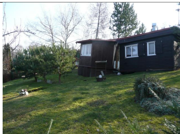
objekt porušený sesuvem – odlučná hrana probíhá přímo pod objektem
