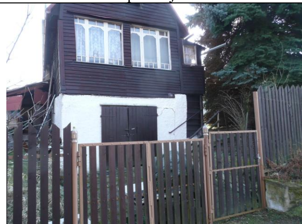
přístavba objektu poškozená sesuvem
