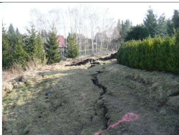
trhliny v horní části sesuvu
