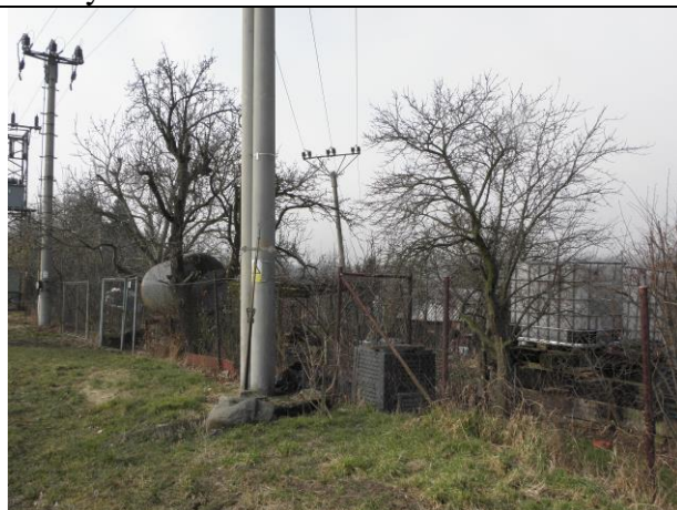
elektrické vedení přes sesuv, patrný náklon sloupu
